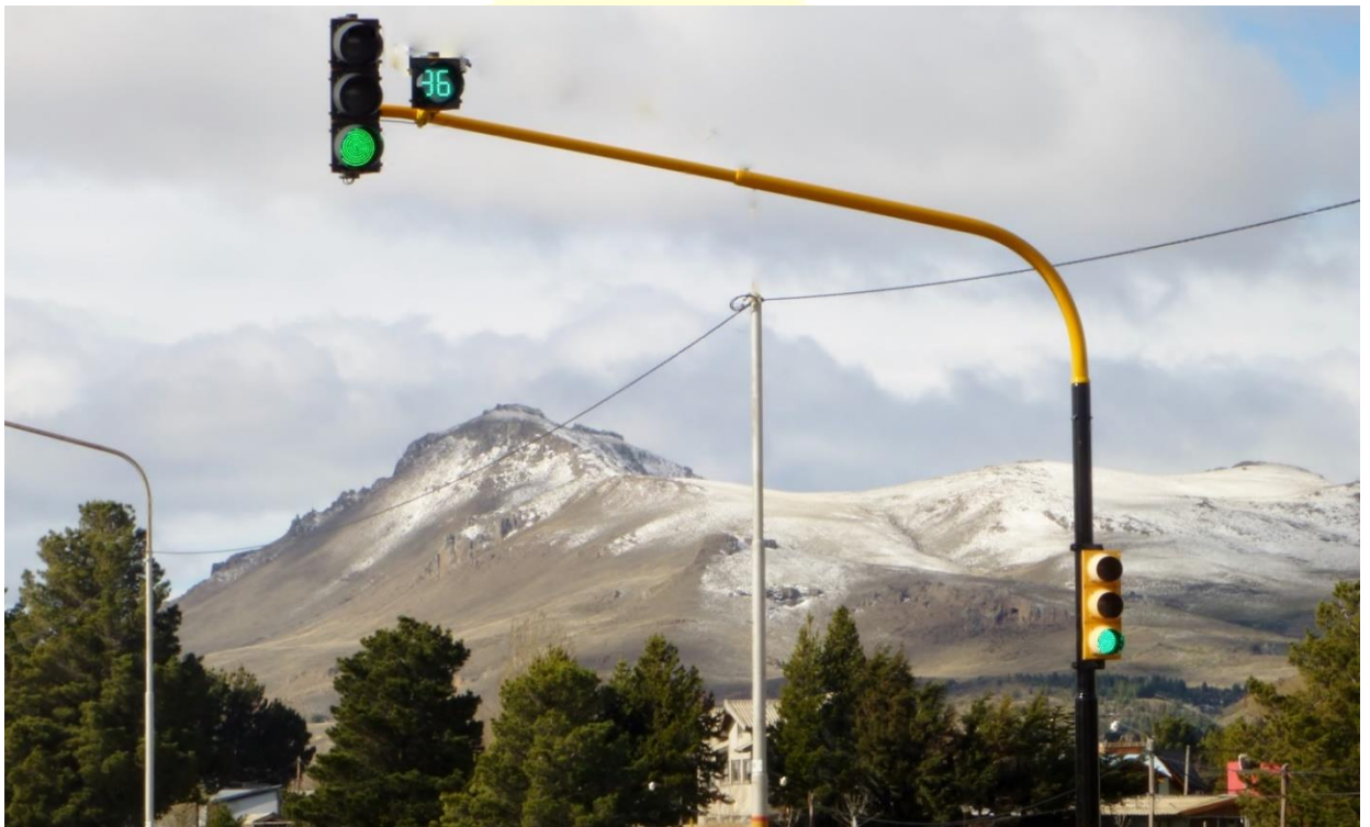
Imagen N° 2 Instalación Realizada en Dina Huapi - Bariloche
